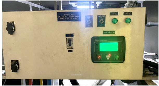
Auto Generator (82.5 KVA 3PH) : पटक पटक लाइन गइरहँदा पटक पटक Gen erator ON/OFF गर्नुपर्ने, मेसिन तथा उपकरणहरू बिग्न सक्ने लगायतका समस्याहरूको समाधानका लागि अटो जेनेरेटर सिस्टमद्वारा लाइन जाँदा आफै चल्ने र लाइन आएपछि आफै बन्द हुने गरी विद्युत आपूर्तिको व्यवस्था मिलाइएको ।
